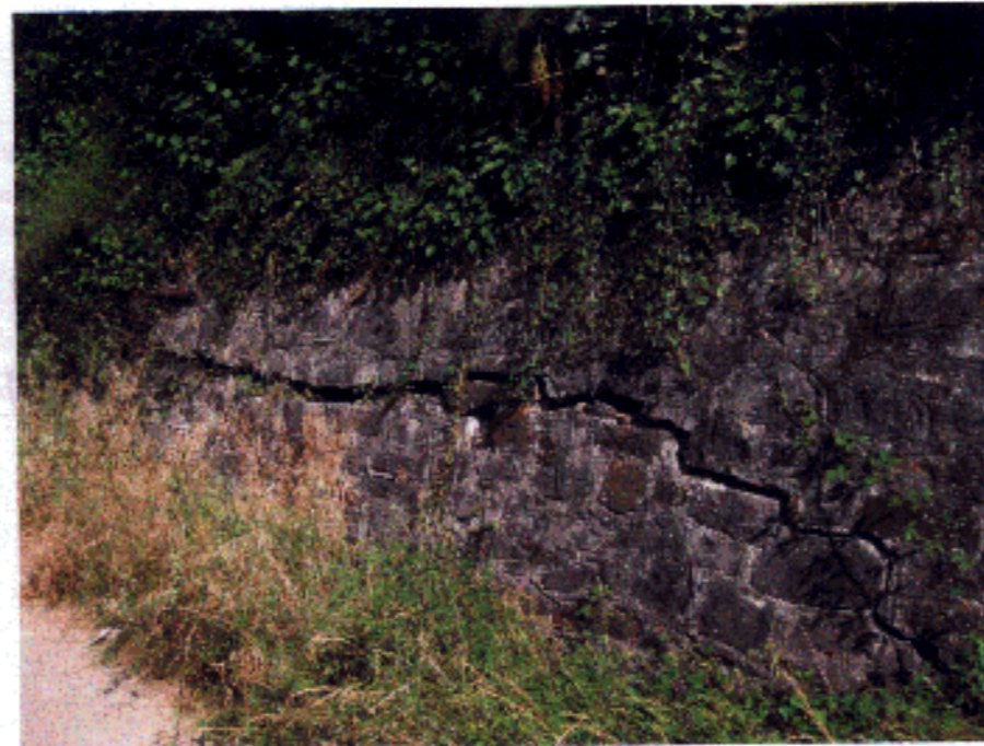
DETALLE DEL MURO DE MAMPOSTERÍA AGRIETADO BAJO LA GI-2832
